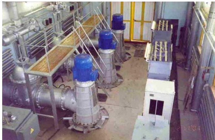
Рис. 4. МикроГЭС (три гидроагрегата микро-ГЭС-50Прпо мощностью по 50 кВт каждый) в с. Кызыл-Хая республики Тыва [10]
