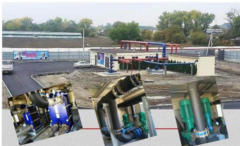
Рис. 3. Геотермальная станция Ханкальского месторождения.
