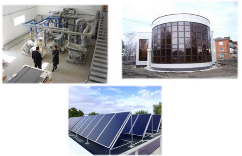
Рис. 4. Геотермальная станция поселка Розовый.
