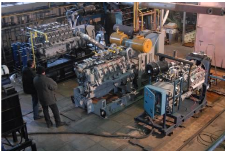
Рис. 3. Общий вид стенда ОИВТ РАН для отработки режимных параметров отечественных электростанций и мини-ТЭЦ на базе газопоршневых двигателей. Слева направо: мини-ТЭЦ мощностью 200 кВт эл. (300 кВт тепловых), 315 кВт эл. (460 тепловых), 100 кВт эл. (150 тепловых)
